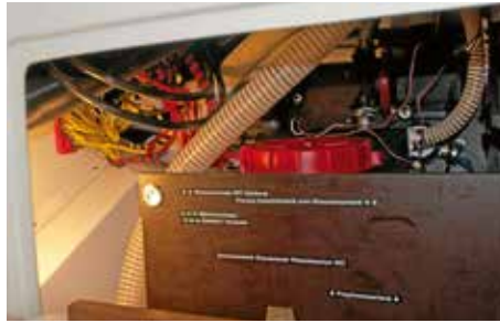
Sauber verlegt, gut zugänglich und beschriftet. Das erleichtert Wartungsarbeiten.
